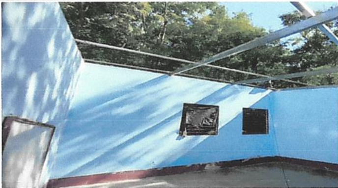
1. Cambio de cubierta de lámina y estructura de metal y pintura en muros .
